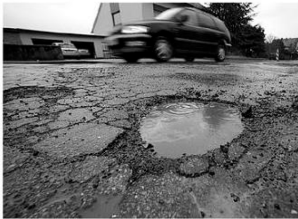
In keinem guten Zustand: Viele Risse und Schlaglöcher kennzeichnen derzeit den oberen Teil des Spradower Weges. FOTO: TOBIAS HEYER
